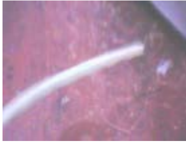
Kabel UTP yang belum di kupas
